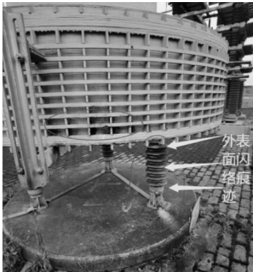
图1 故障电抗器 Fig. 1 Faulty reactor
