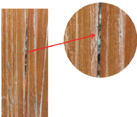
图 9 非故障相电抗器外包封裂口 Fig. 9 Cracks in the outer encapsulation of the non-faulty phase reactor
