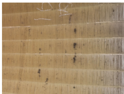
图 8 非故障相电抗器积灰情况 Fig. 8 Dust accumulation on the non-faulty phase reactor
