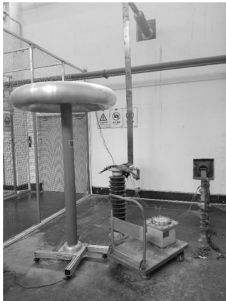
图 1 电气绝缘测试过程 Fig. 1 Electric insulation test procedure
