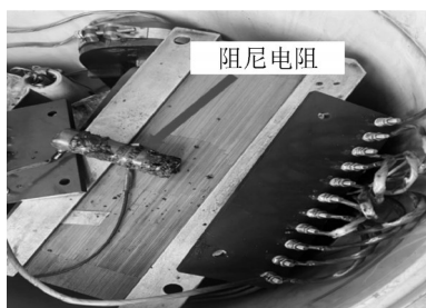
图1 阻尼电阻故障情况图
